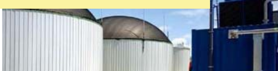
Impianto per la produzione di biogas
