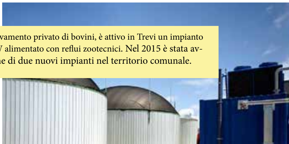
Impianto per la produzione di biogas
