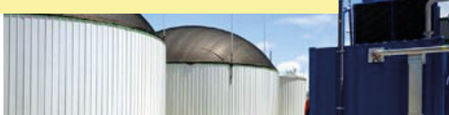
Impianto per la produzione di biogas
