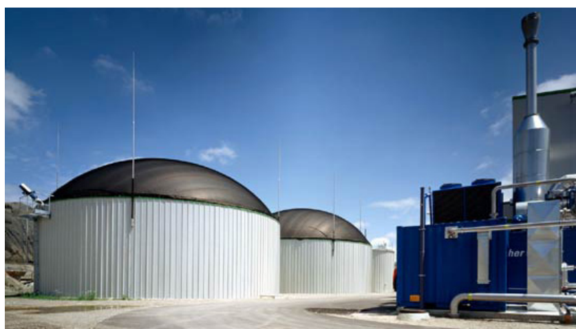
Impianto per la produzione di biogas
