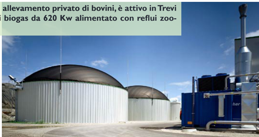
Impianto per la produzione di biogas
