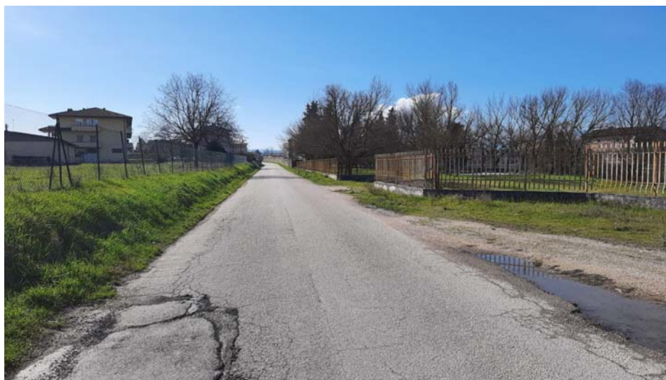
Figura 6 – assenza di marciapiedi, banchine, p.ill e sistema raccolta acq. meteoriche
